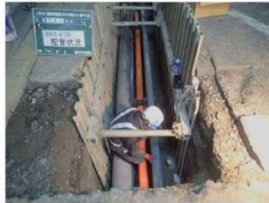
⑩配管状況
